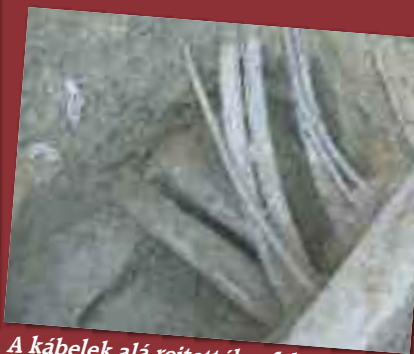
A kábelek alá rejtették a feketén csatlakoztatott két csővezetéket
